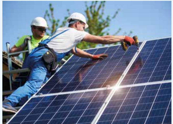
Auf noch mehr Dächern in Hessen sollen Solaranlagen montiert werden. (Foto: anatolij_gleb / stock.adobe.com)
