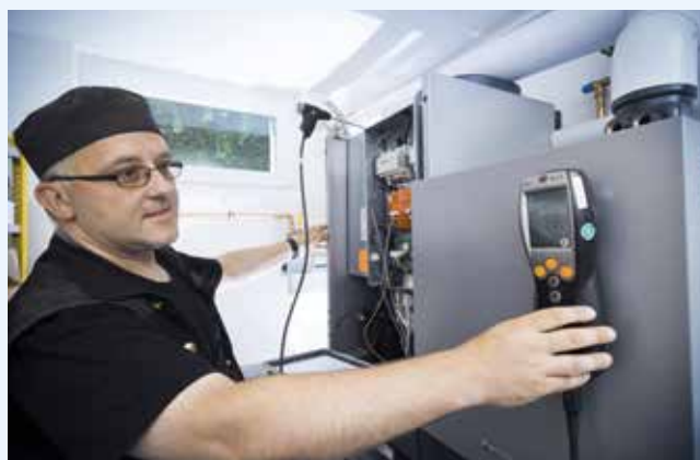
Energieeffiziente Brennstoffzellen-Heizgeräte sind einfach in Kellern von Wohngebäuden zu installieren. (Foto: Hosan / HA Hessen Agentur GmbH)
