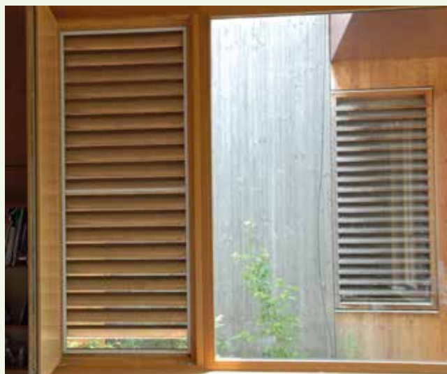
Nachtluftklappen können die Nachtentlüftung unterstützen und für Abkühlung sorgen. (Foto: Stadt Frankfurt a.M., Amt für Bau und Immobilien, Abteilung Energiemanagement)
