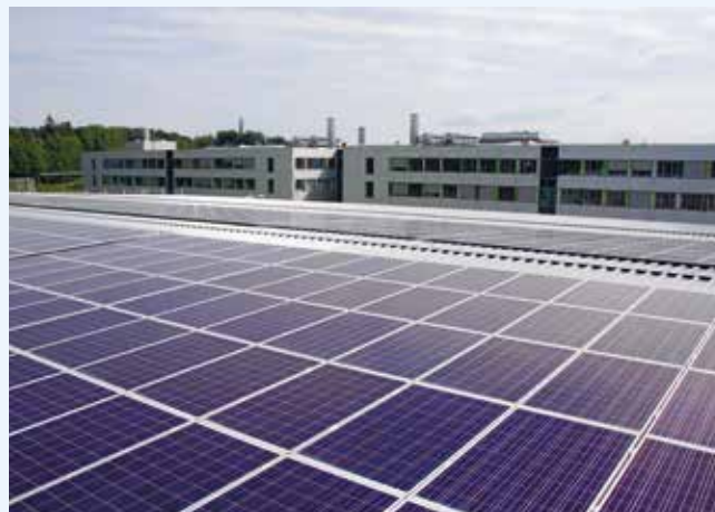
Photovoltaikanlage an der Philipps-Universität Marburg. (Foto: Ulrich Rustige)
